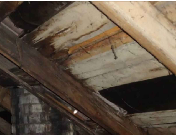
Dėl susidėvėjusios ir nesandarios stogo dangos stogo konstrukcijos pažeistos puvinio.
