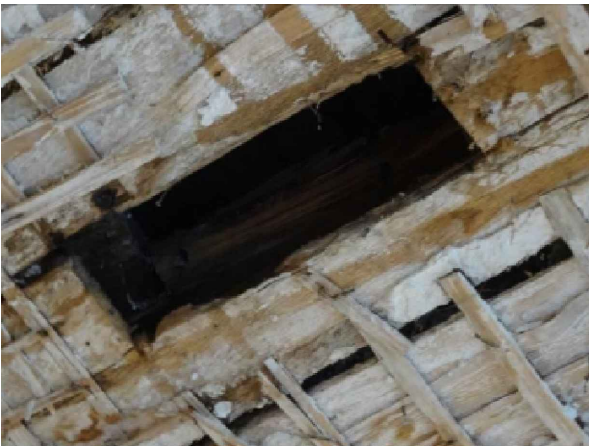
Dėl drėgmei pralaidaus stogo, nukritęs lubų tinkas, puvinio veikiamos perdangos konstrukcijos.
