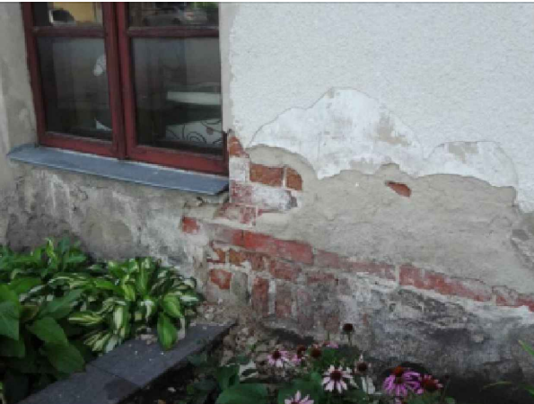
Dėl drėgmės, kylančios pastato pamatu, atšokęs pastato sienų tinkas
